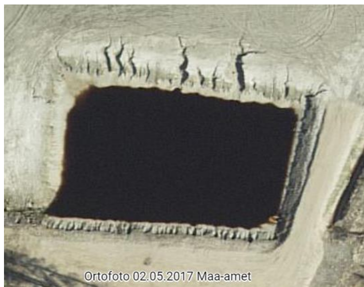
Joonis 2.56. Nõlva erosioon liivapinnases Pikanõmme (6 112 350 010 010) ehitisel (fotod 2021 sügis ja 2017 kevad).
