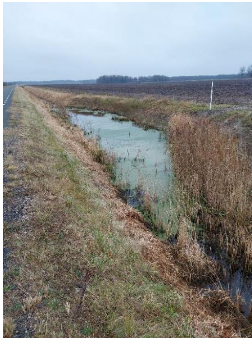
Joonis 2.7. Harjumaa Endla maaparandusehitise 20 m pikkune settebassein (settega täitumine 42% setteruumi sügavusest).
